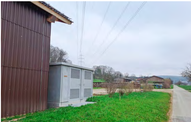
Neue Trafostation Neugut
