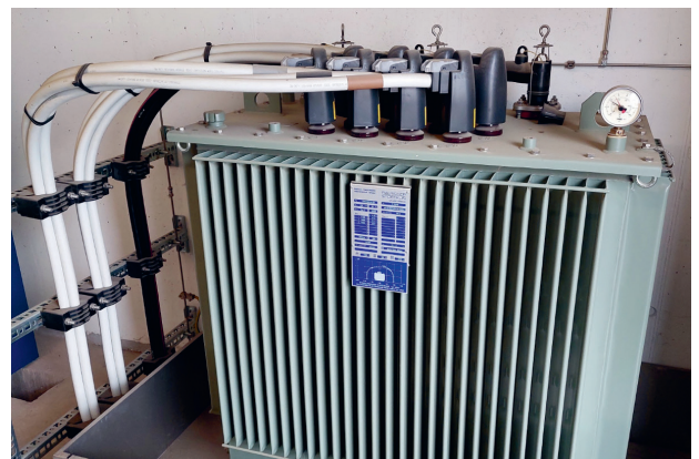
Trafostation mit gekapselten Anschlüssen
