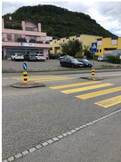
Abbildung 20: Schutzinsel nicht behindertengerecht
