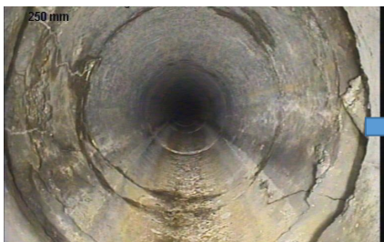
Abbildung 1: Kanalisationsleitung mit Schaden
